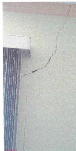
Figura 35 – Rachadura em torno da janela -Sala1– Pav. Subsolo – Sala “José Antonio de Oliveira”
