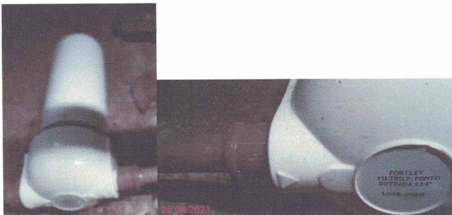
Figura 31 e 32 – Filtro de água no forro do telhado
