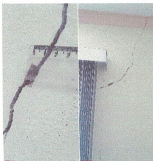
Figura 24 e 25 – Parede rachada na sala 1 junto a parede estrutural.
