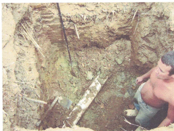
Figura 18 – Tubulação que estava obstruída e se mantém atualmente obstruída.
