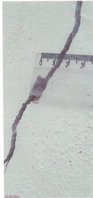
Figura 34 – Rachadura em torno do ar condicionado e janela - Sala 1 – Pav. Subsolo – Sala “José Antonio de Oliveira”
