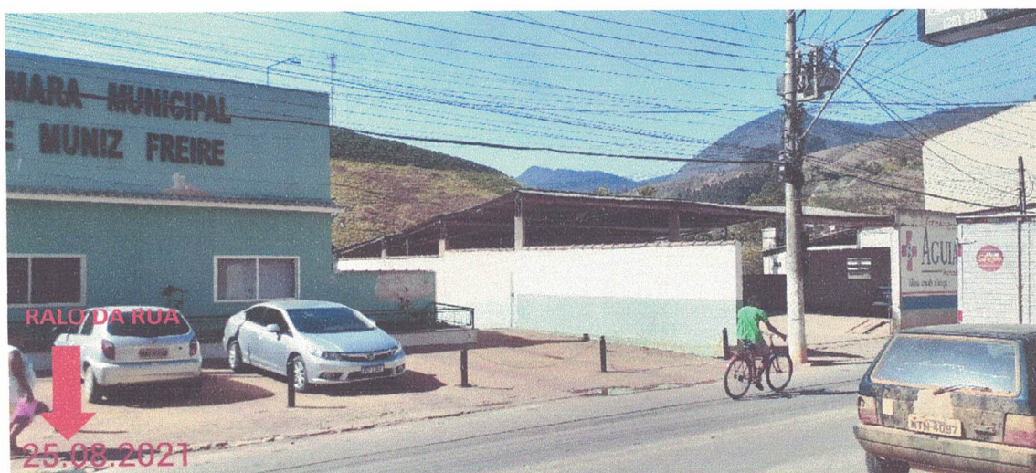
Figura 19 – Ralo em frente a Câmara atualmente sem saída de águas.
