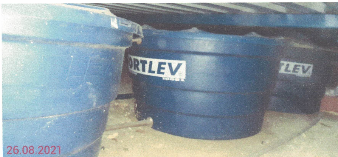
Figura 30 – Visão das caixas d' água.
