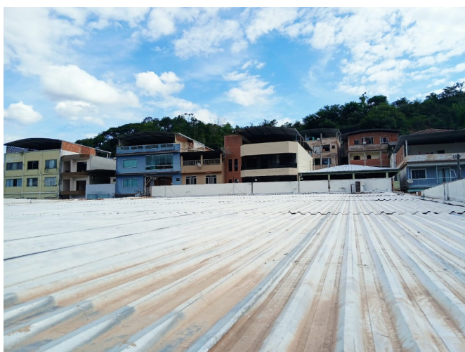
Fotografia 2 – Telhado a ser consertado.
