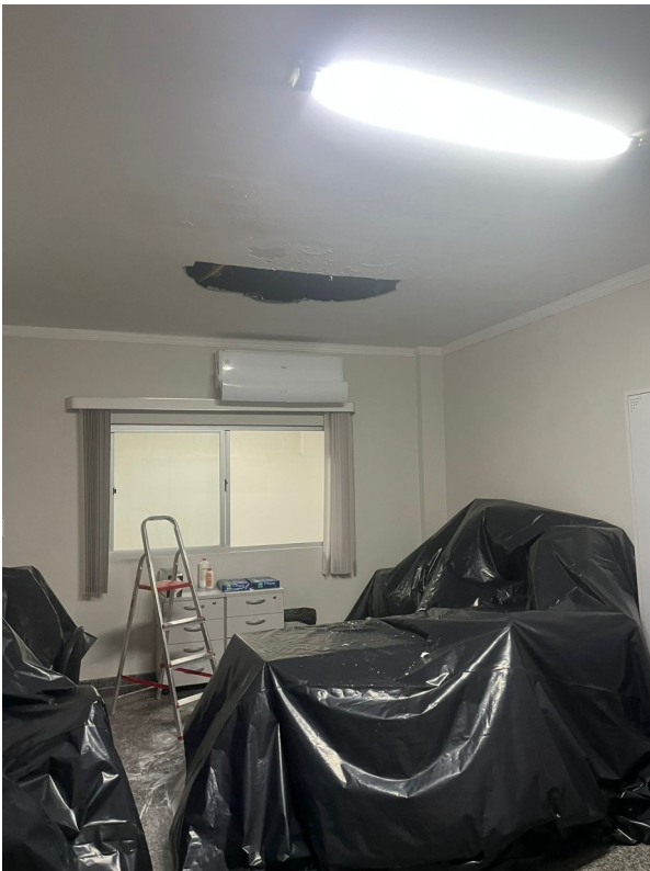
Fotografia 4 – Forro de Gesso a ser trocado.
